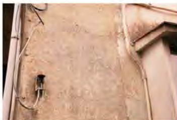
外壁のひび割れ ・コケ
