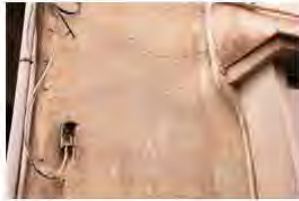
外壁のひび割れ・こけ
