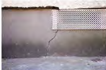
換気口付近の ひび割れ
