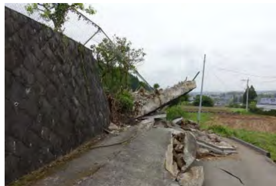
写真11 崩壊した擁壁
