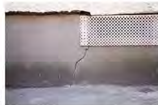
基礎のひび割れ
