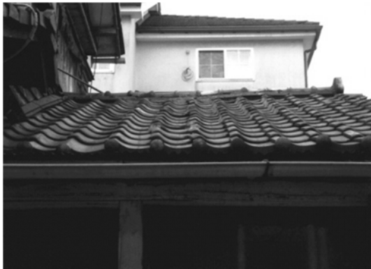
写真Ⅱ.2.3.1 屋根の波打ち (中央上部の屋根の棟線にたわみが見られる)
