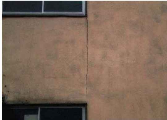
写真Ⅱ.2.3.2 モルタル外壁に生じた大きなひび割れ
