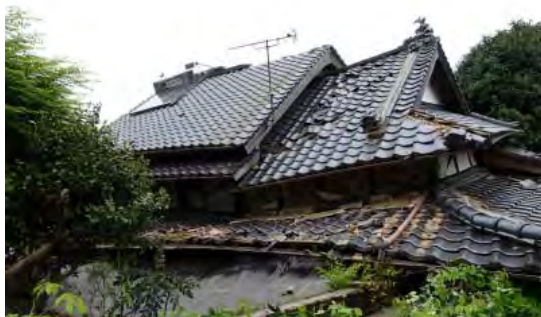
写真8 倒壊した木造住宅
