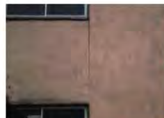
外壁の ひび割れ
