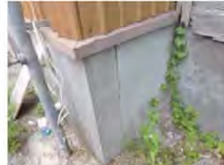
基礎の ひび割れ
