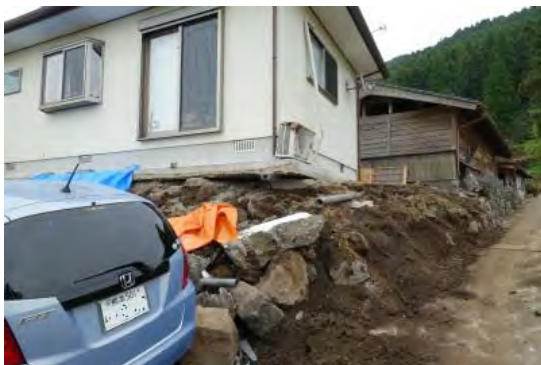
写真10 崩壊した擁壁
