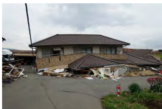
写真 16 倒壊した木造住宅
