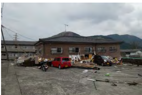
写真 14 倒壊した木造アパート
