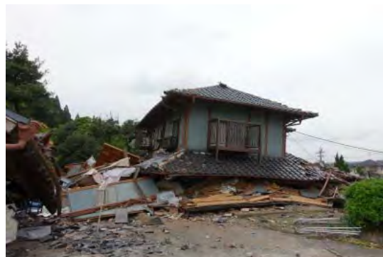
写真9 倒壊した木造住宅
