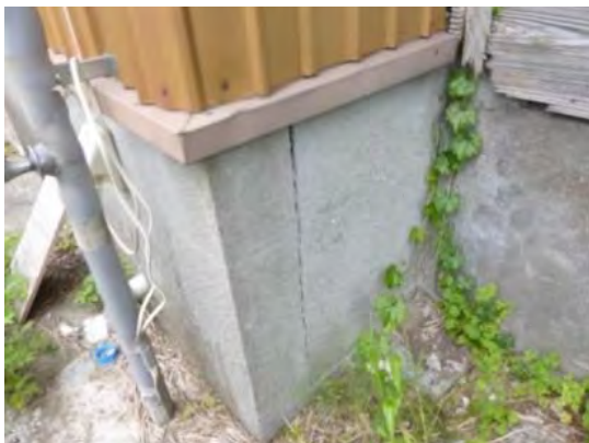
写真Ⅱ.2.3.3 基礎の割れ
