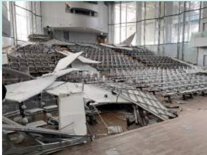
(福島県沖地震による宮城県白石市ホワイトキューブ天井落下の様子/JACCA撮影)
