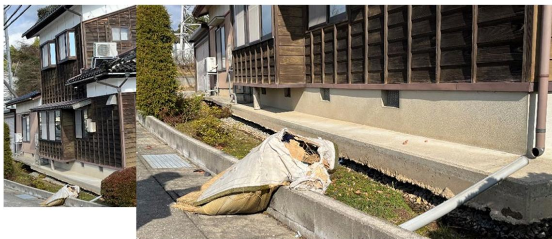
写真-4 地盤の沈下は部分的で収まっており、基礎の一体性が保たれている（Bランク）
