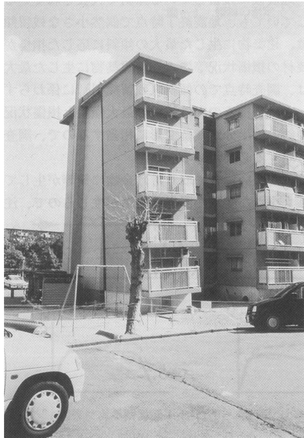
写真-10 不同沈下によって傾斜した集合住宅
