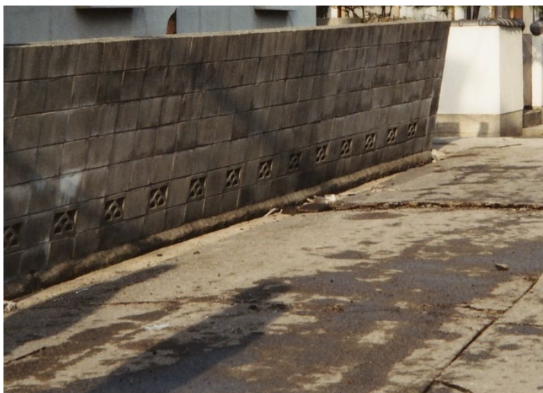
写真-23 転倒危険物（ブロック塀）（Cランク）
