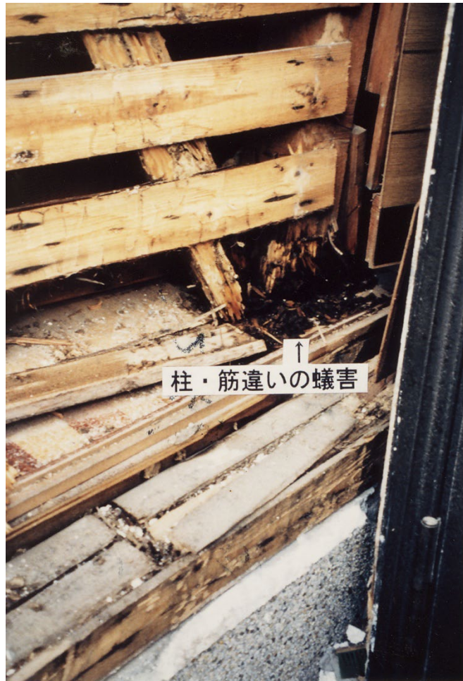
写真-17 蟻害（Cランク）
