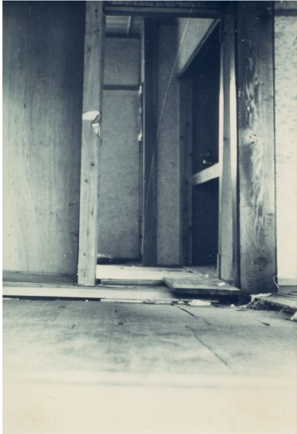
写真-5 建築物の不同沈下(Aランク)
