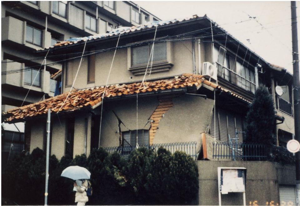
写真-20 落下危険物（瓦）（Cランク）
