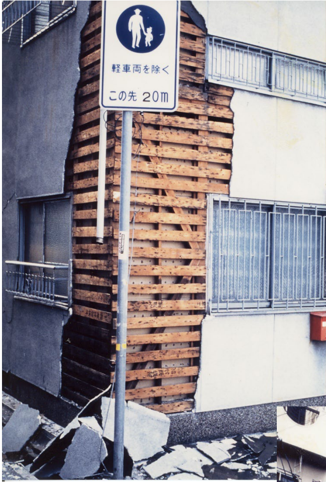
写真-14 壁の被害(外壁) (Bランク)
