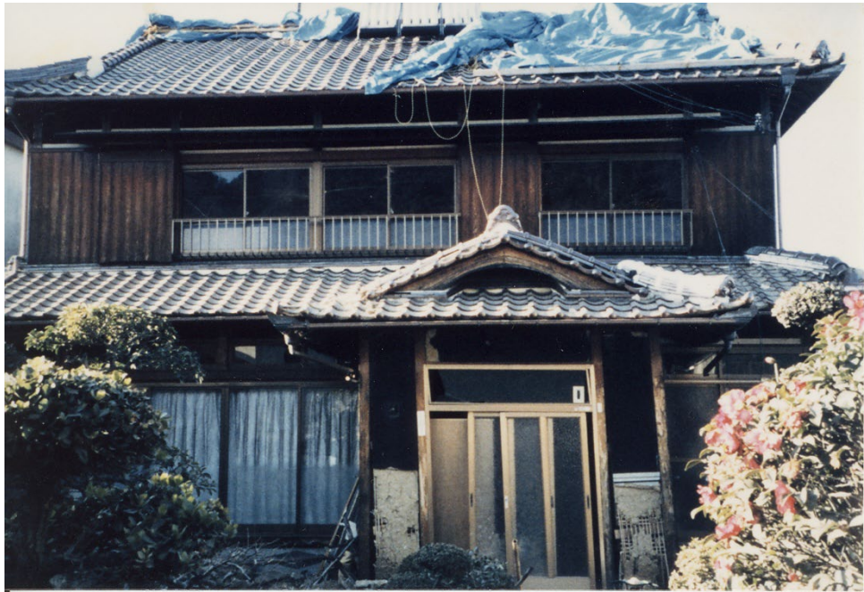
写真-9 建築物の1階の傾斜(Bランク)
