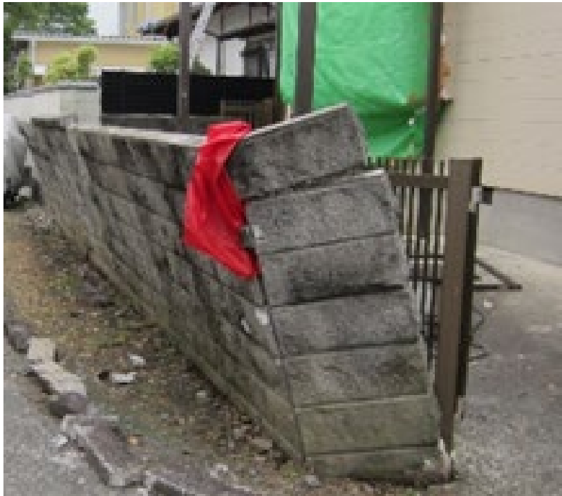
写真-25 転倒危険物（ブロック塀）（Cランク）
