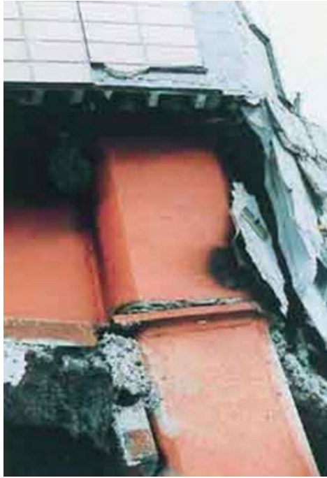
写真-19 柱と通しダイアフラムとの溶接接合部の破断
