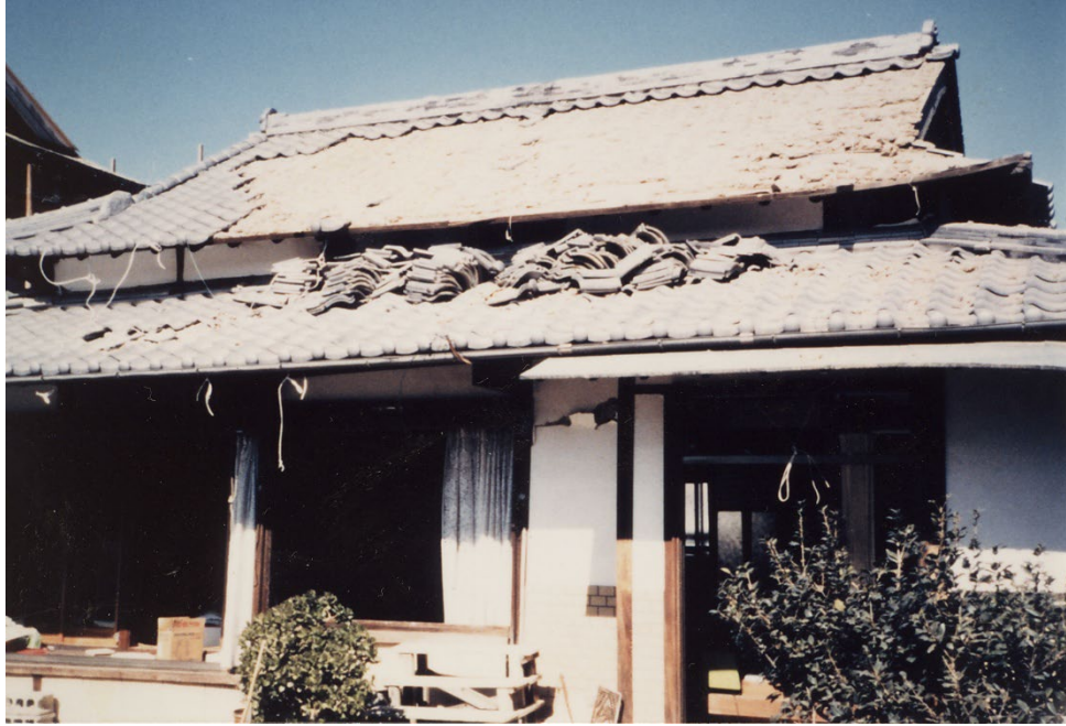
写真-19 落下危険物（瓦）（Bランク）
