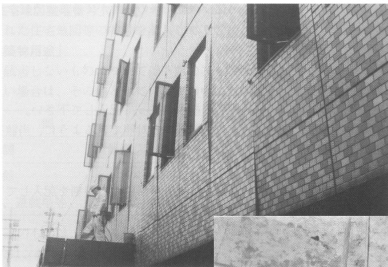
写真-1 純ラーメン5階建事務所ビルのPCカーテンウォールの損傷
