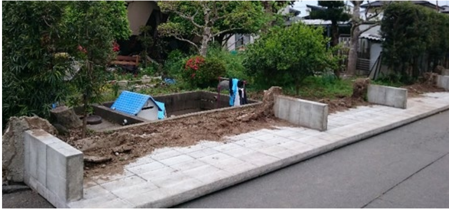
写真-21 転倒危険物（ブロック塀）（Aランク）* （*これ以上転倒する危険はない）
