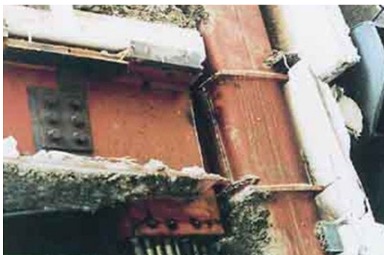
写真-18 梁端接合部における溶接部の破断
