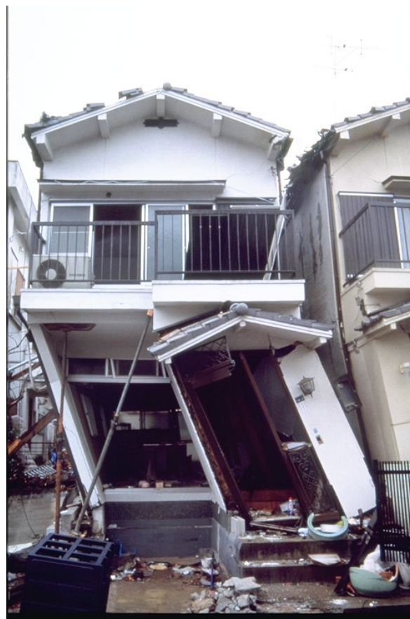
写真-10 建築物の1階の傾斜(Cランク)
