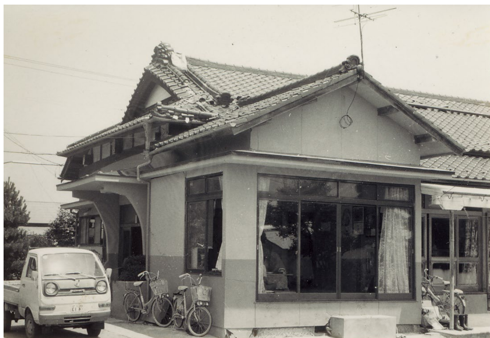
写真-18 落下危険物（瓦）（Aランク）
