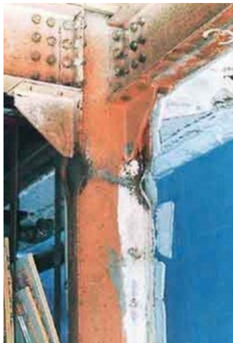
写真-13 局部座屈が生じた柱
