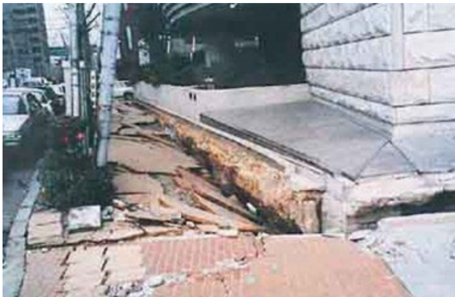
写真-8 地盤の液状化によって沈下した建築物周辺
