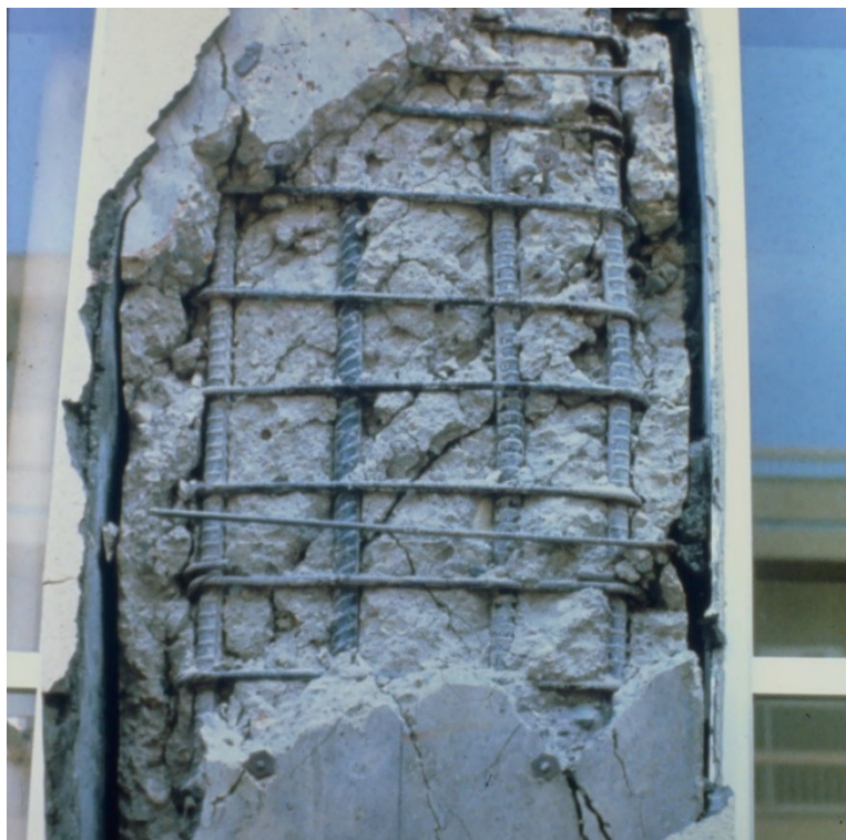
(b) コンクリートの剥落が激しく、鉄筋が広範囲にわたって露出している
