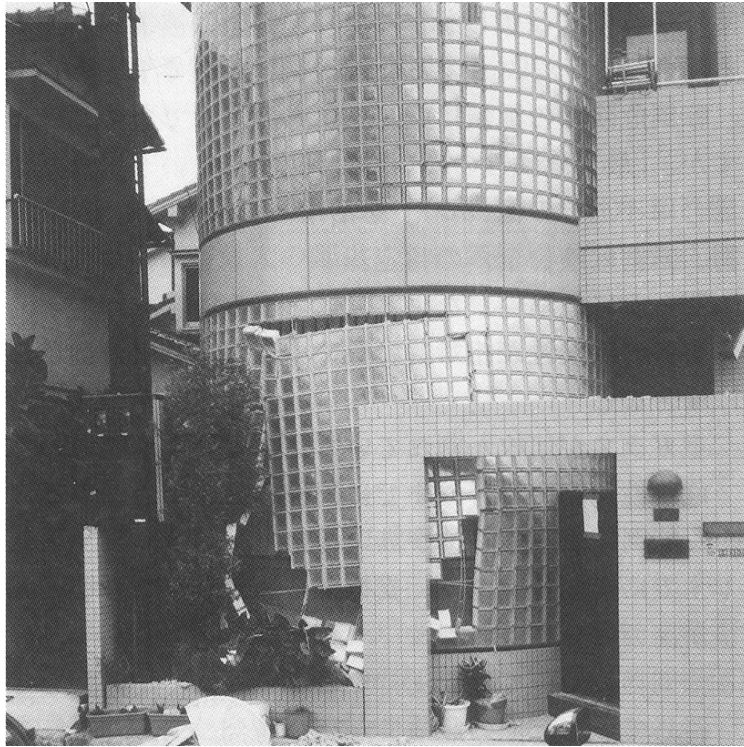
図-10 落下危険物のCランクの例
