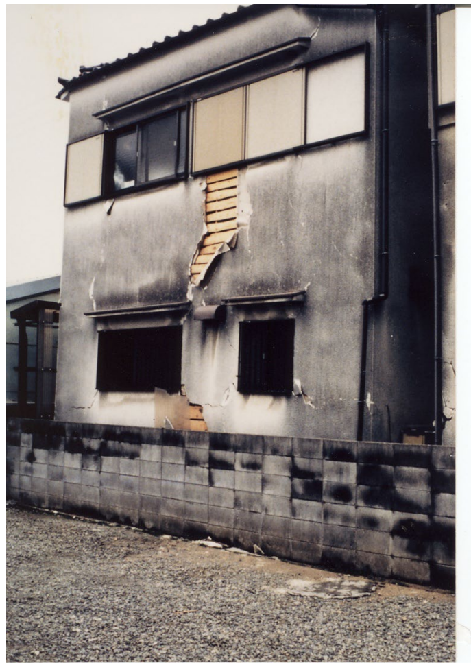
写真-13 壁の被害(外壁)(Bランク)
