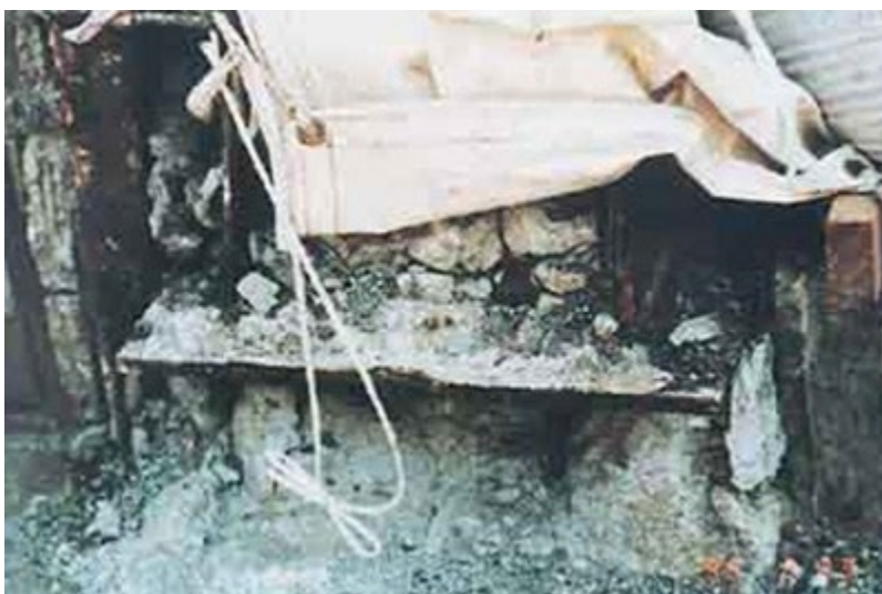
写真-21 軸力支持能力を失った柱脚ベースプレート下部コンクリート
