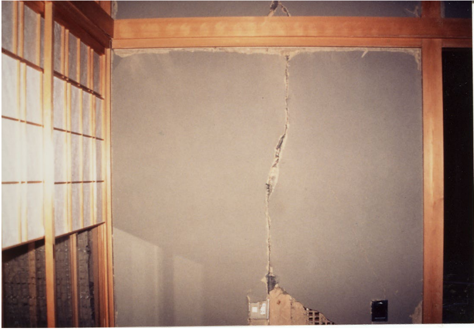
写真-12 壁の被害(内壁)(Bランク)
