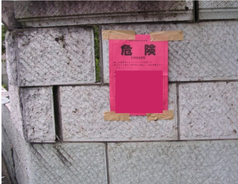
写真-24 転倒危険物（ブロック塀）（Cランク）
