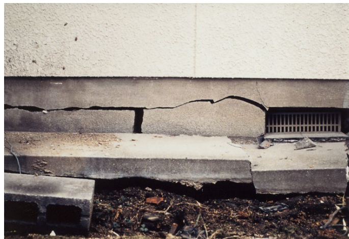
写真-8 基礎の被害(Cランク)
