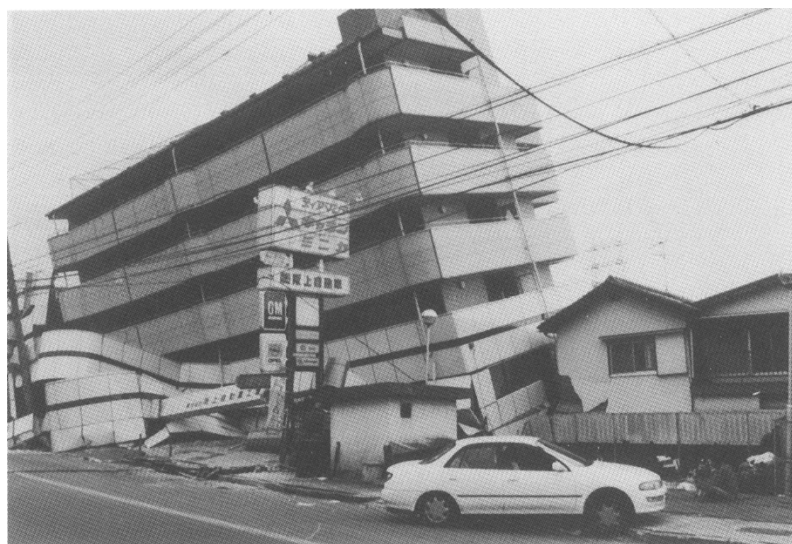
写真-3 低層階で落階した建築物
