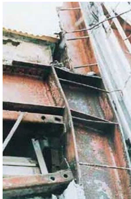
写真-14 著しく腐食した柱材の局部座屈
