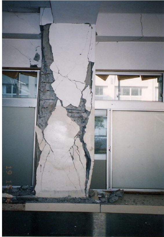
(c) コンクリートの剥落が激しく、鉄筋が広範囲にわたって露出している (鉛直方向の変形がある場合には損傷度Ⅴとなる)
