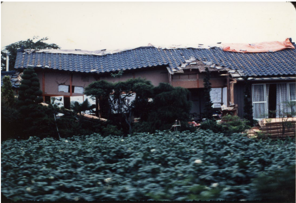
写真-6 建築物の不同沈下(Bランク)
