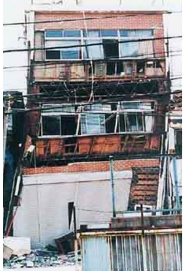
写真-12 1、2階に傾斜が生じた建築物
