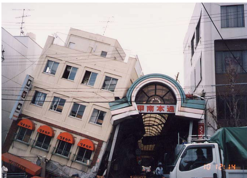
写真-7 アーケードへの倒壊の危険性のある建築物
