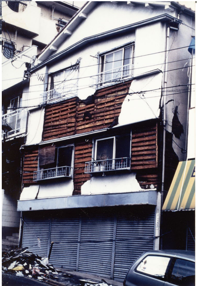
写真-15 壁の被害(外壁) (Cランク)
