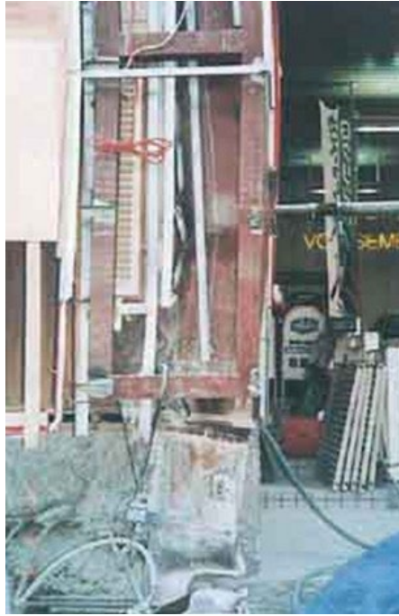
写真-15 全体座屈が生じた柱
