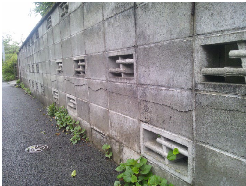
写真-22 転倒危険物（ブロック塀）（Bランク）
