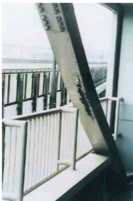
写真-17 H形鋼筋かいの座屈
