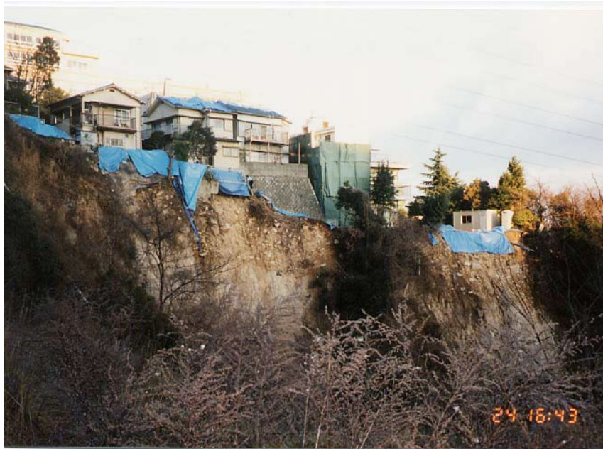
写真-6 建築物の敷地の崩壊危険
