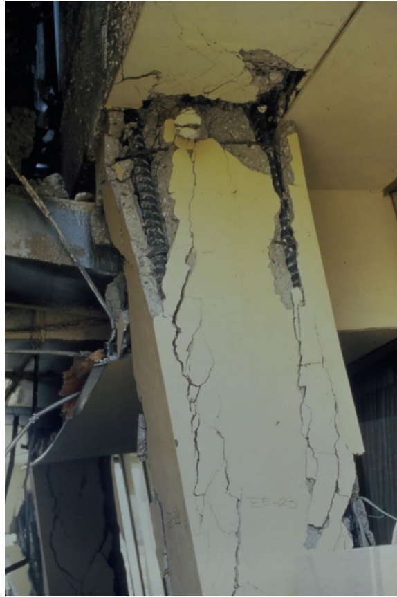
(a) 柱頭のコンクリートの剥落し、鉛直方向の主筋が広範囲に露出し、鉄筋に沿った大きなひび割れが柱の中央部まで広がっている
