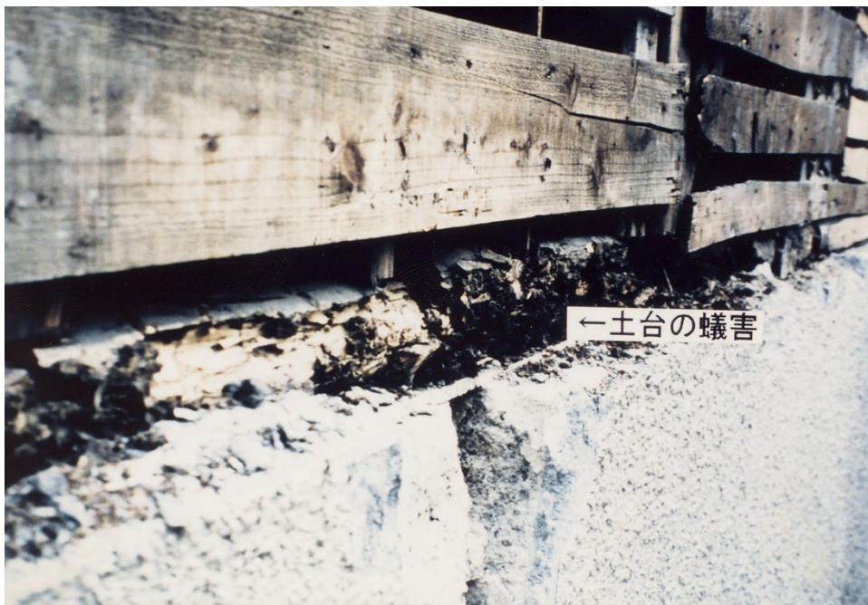
写真-16 蟻害（Cランク）
