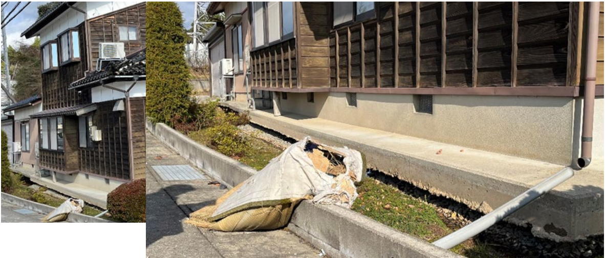
写真-4 地盤の沈下は部分的で収まっており、基礎の一体性が保たれている（Bランク）
