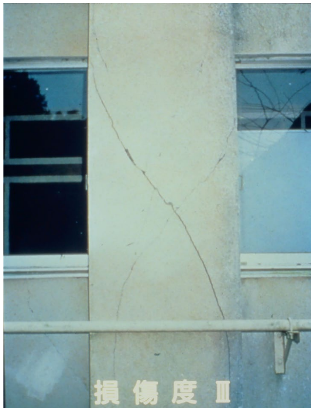
(b) 腰壁の影響で短柱となる左から右への変形時に柱にせん断ひびわれが発生している
