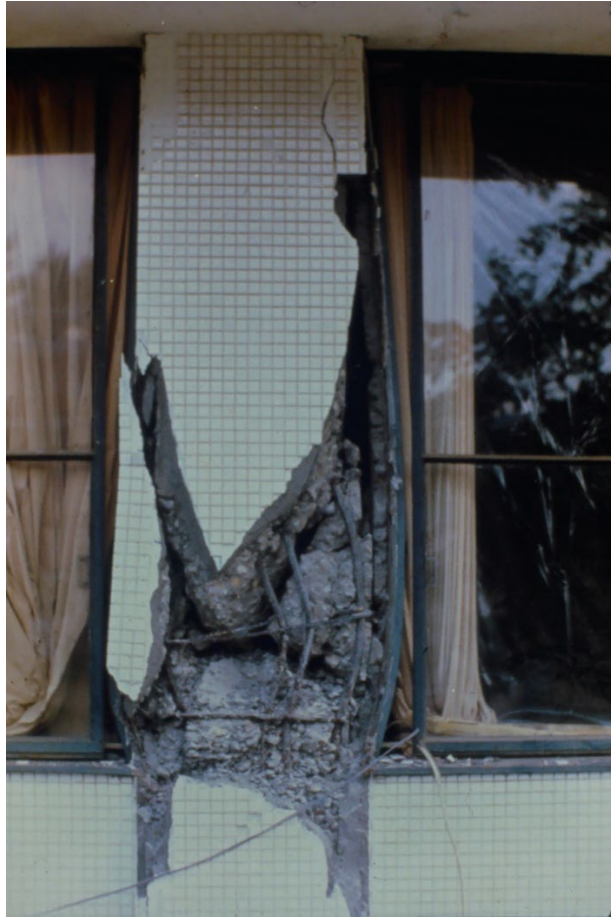
(a) 鉄筋が曲がり、内部のコンクリートも崩れ落ち、一見して柱の高さ方向に変形が生じていることがわかる
