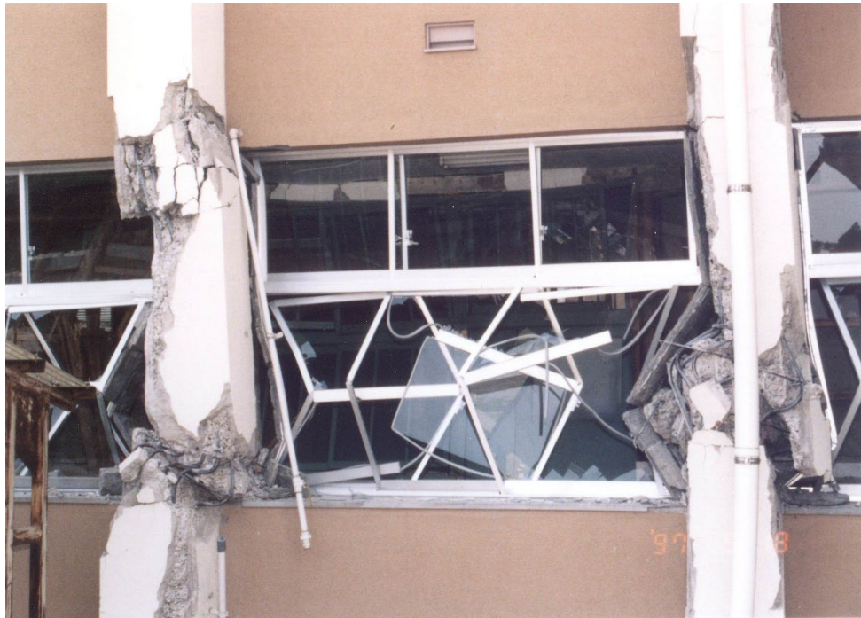
(b) 柱頭および柱脚が曲げせん断破壊し高さ方向に変形が生じている
