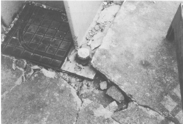
写真-22 露出柱脚における軽微な損傷
