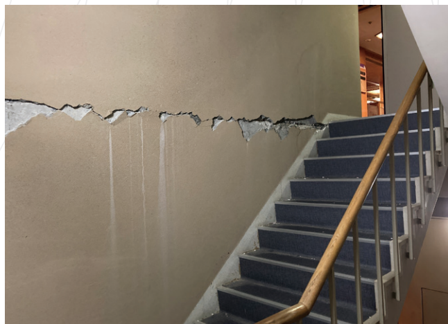
室内壁面に大きくひびが入った写真
